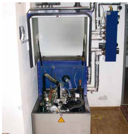
Das BHKW ist seit April 2010 in Betrieb.
