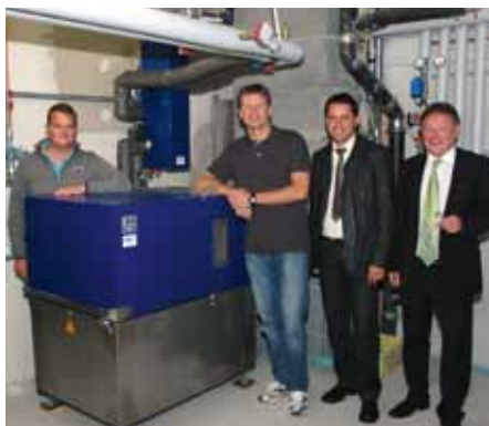
Seit Mai 2010 im Einsatz – das BHKW
