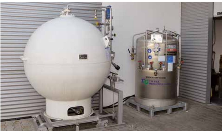
Tankanlage der TKS für die Lagerung von 1,1 Tonnen Flüssigkohlendioxid und CryoEase®-Behälter für Flüssigstickstoff
